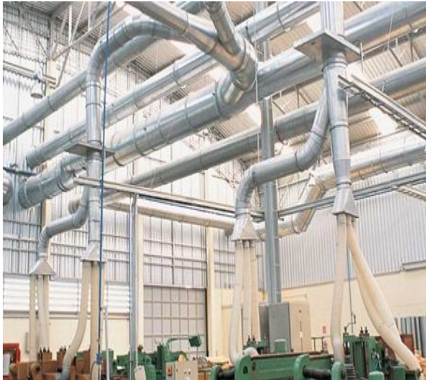
Hệ thống ống hút, đường ống dẫn
