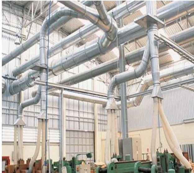
Hệ thống ống hút, đường ống dẫn
