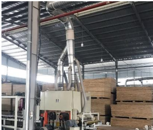
Hệ thống ống hút, đường ống dẫn
