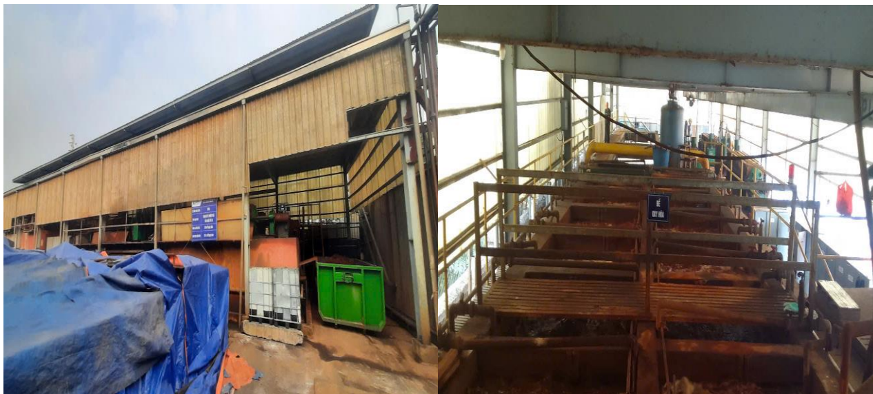
Hình ảnh trạm xử lý nước thải sản xuất của Chi nhánh Công ty
