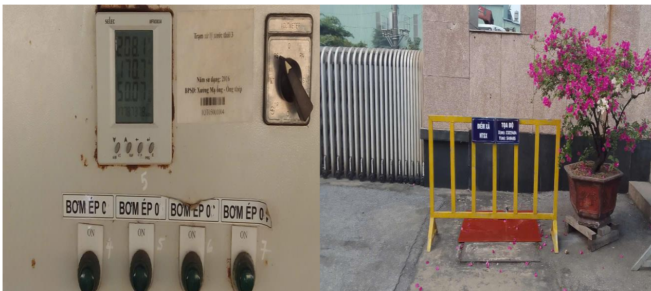
Hình ảnh công tơ điện của hệ thống Hình ảnh hố ga thu gom nước thải sản xuất sau xử lý trước khi đấu nối vào công thoát nước của đường ĐH11 (đường ống thoát và đấu nối ngầm)
