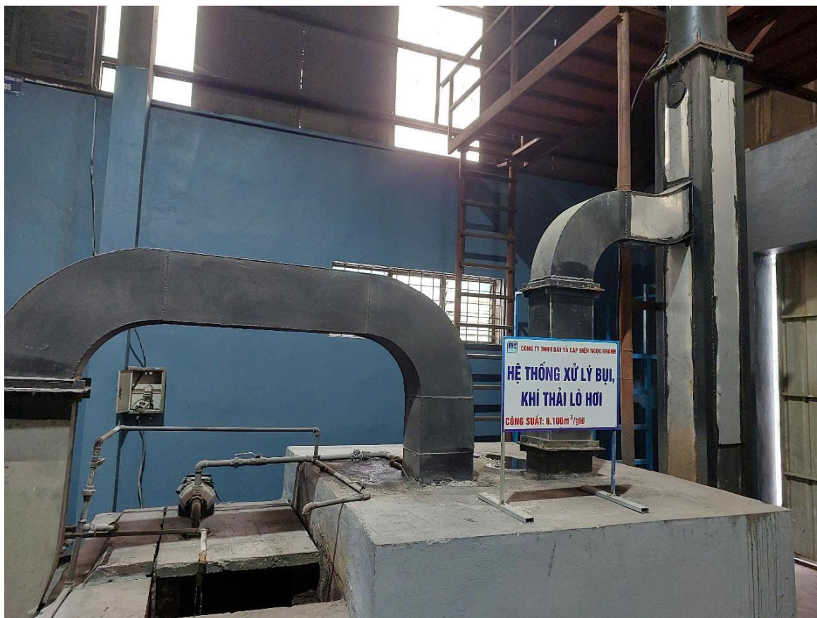
Hình ảnh hệ thống xử lý khí thải lò hơi
