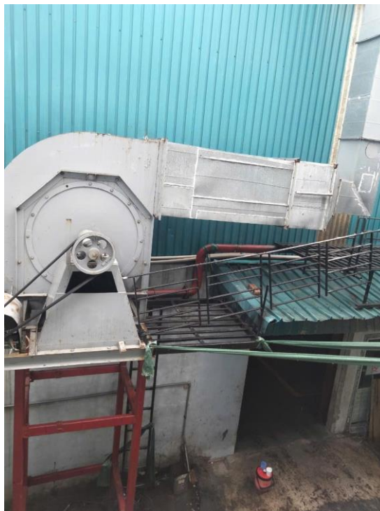
Hình ảnh hệ thống xử lý khí thải
