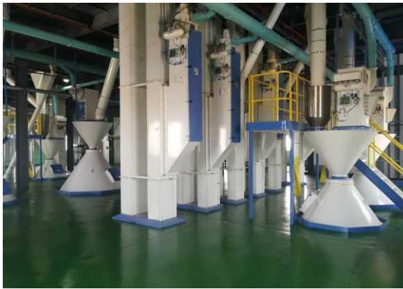
Hình ảnh thiết bị thu hồi bụi bằng túi vải kèm theo tại đầu gầu tải
