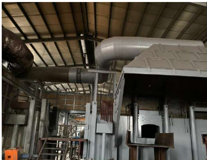
Hình ảnh minh họa hệ thống thu gom khí thải từ lò nấu
