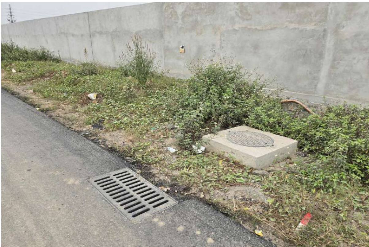
Hình 12. Hệ thống thoát nước chung phía trước công dự án
