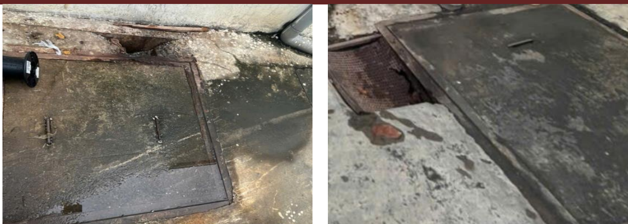
Hình 3.3. Hồ ga thu gom nước mưa bề mặt của cơ sở
