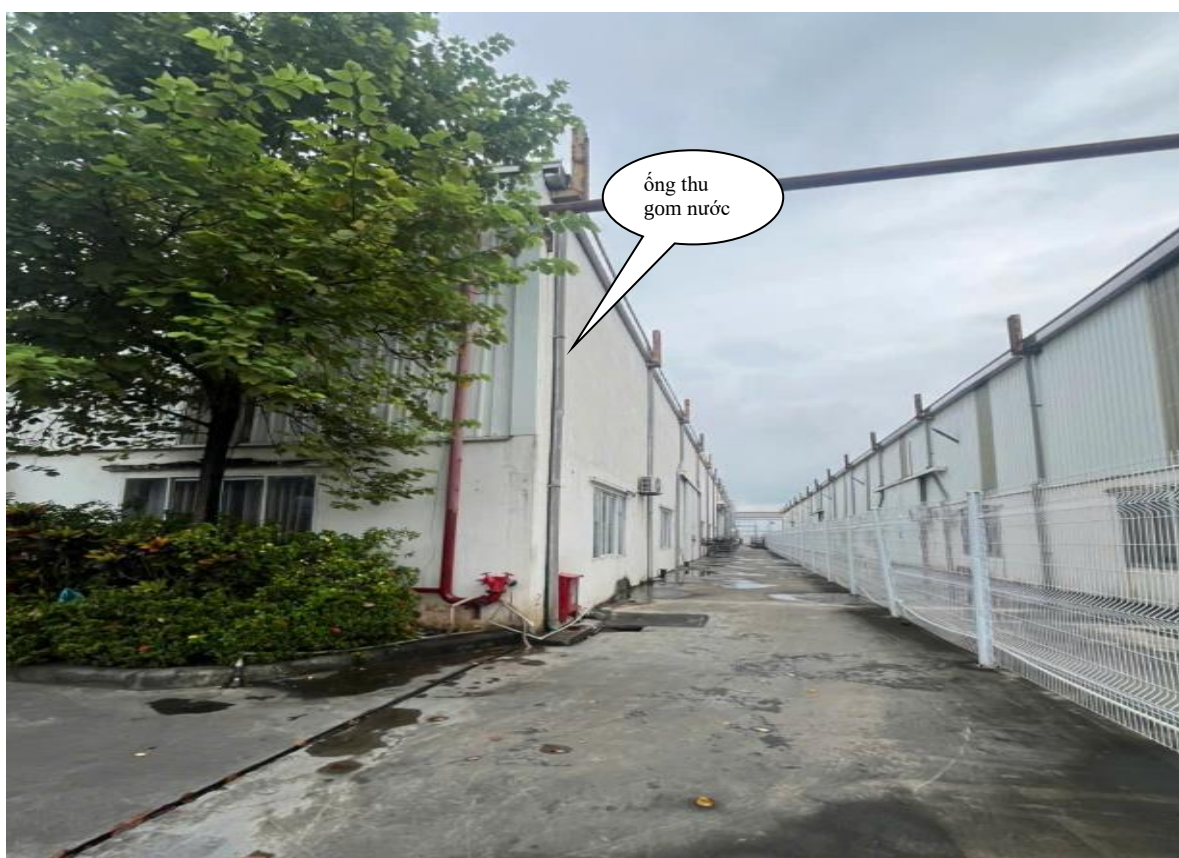
Hình 3.2. Hệ thống ống thu và máng thu gom nước mưa tại mái của cơ sở
