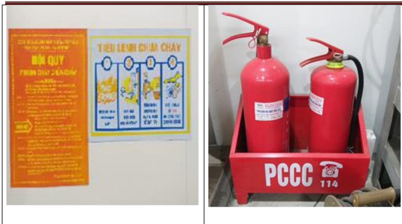
Hình 3.10. Một số hình ảnh về hệ thống PCCC của cơ sở
