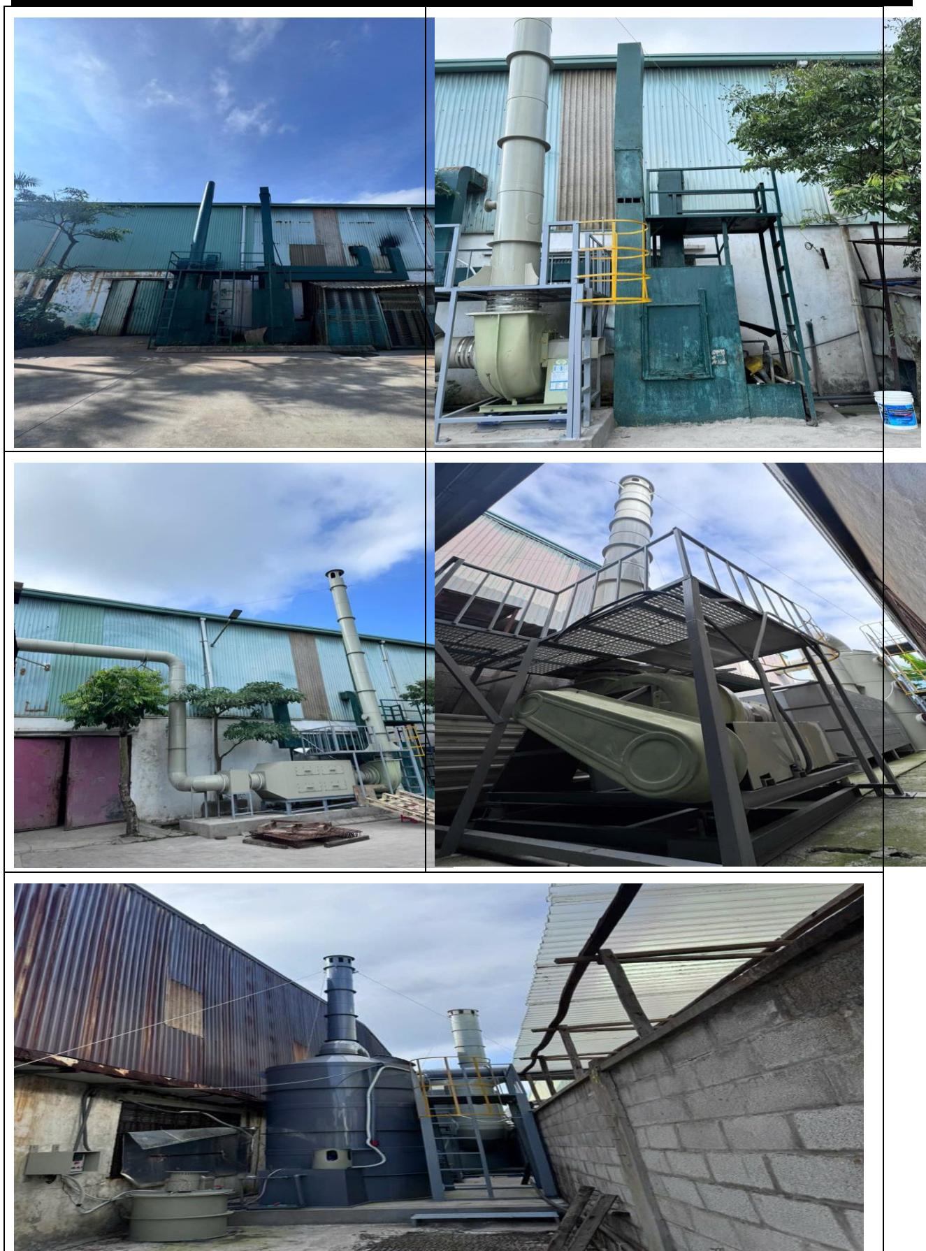
Hình ảnh thực tế HTXLKT tại Nhà máy
