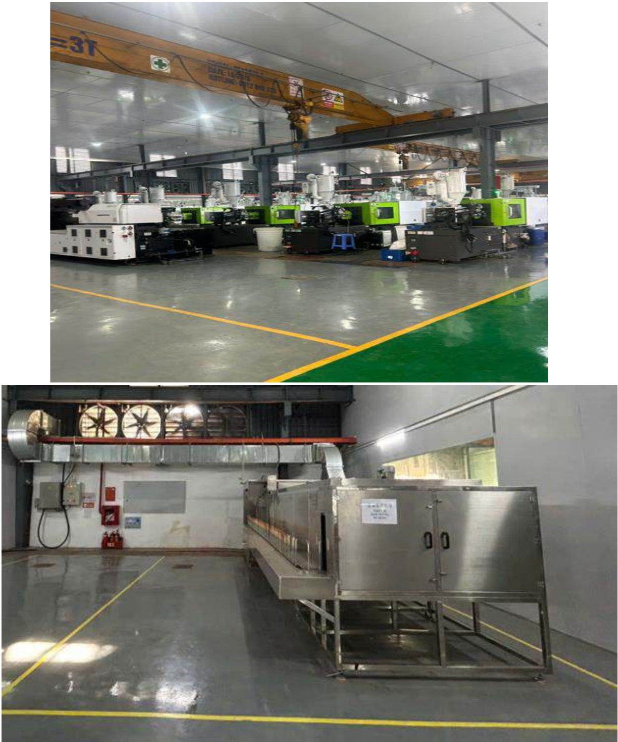
Hình 1. 7. Máy móc, thiết bị đã được lắp đặt tại dự án
