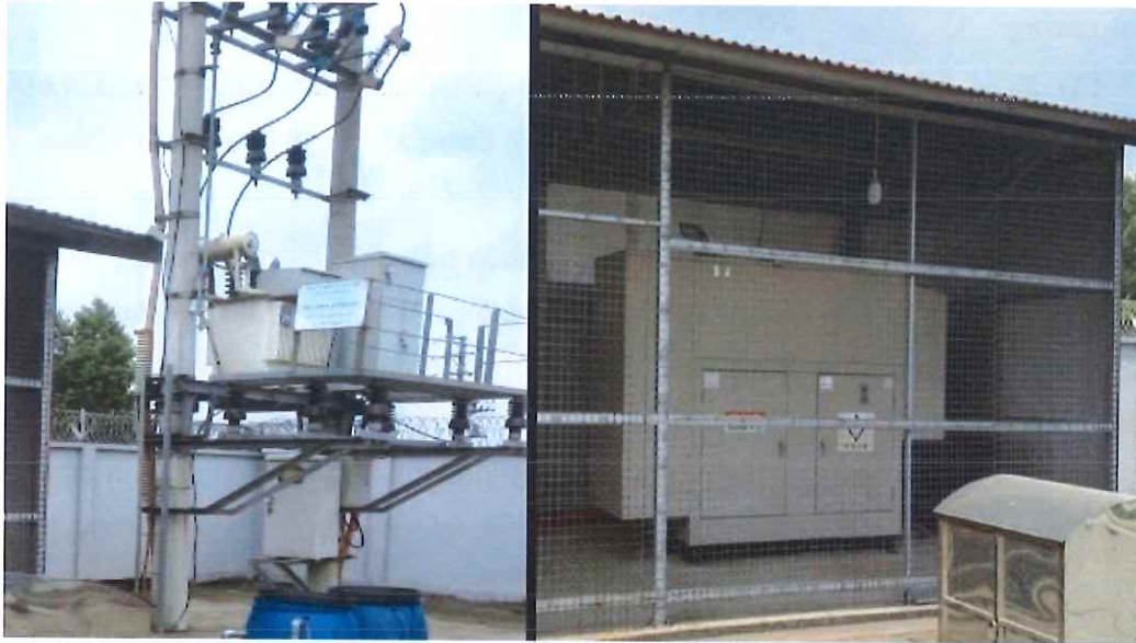
Hình 1.4: Trạm biến áp và máy phát điện dự phòng của nhà máy
