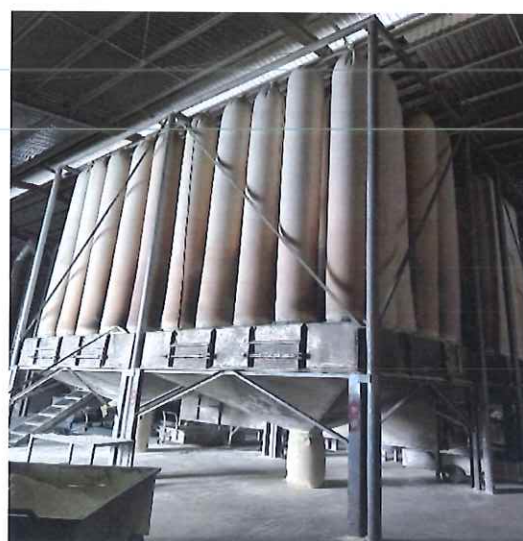
Hình 1.10: Hệ thống lọc bụi túi vải
