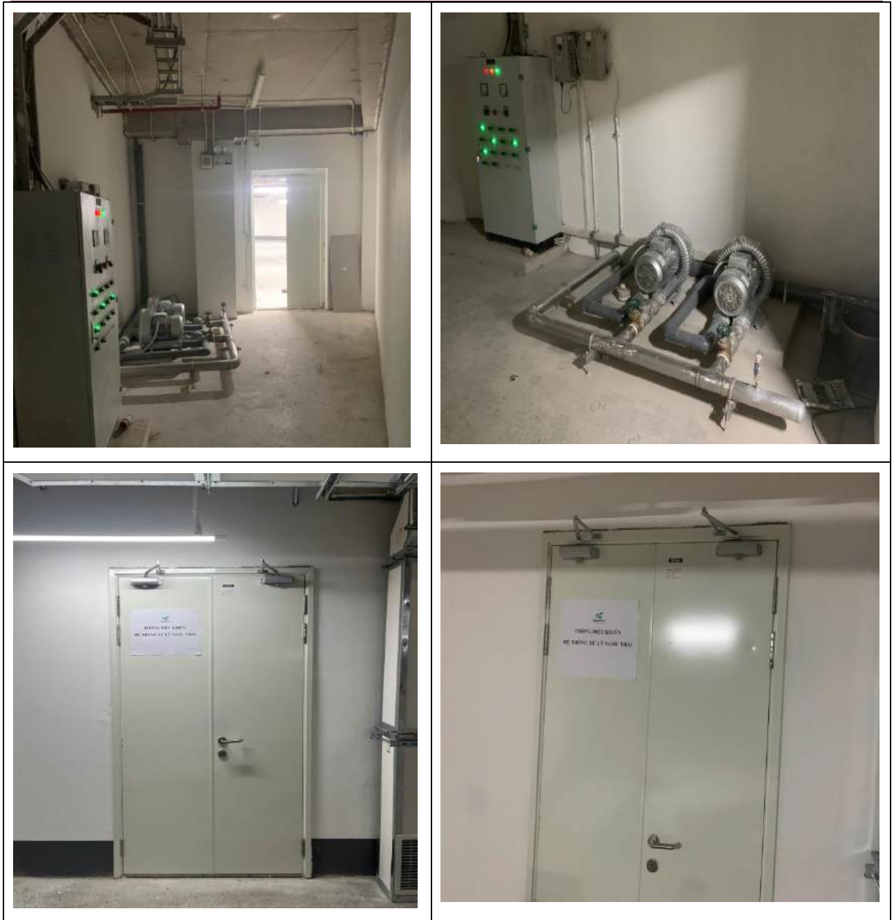
Hình 19. Hình ảnh khu vực xử lý nước thải sinh hoạt của dự án
