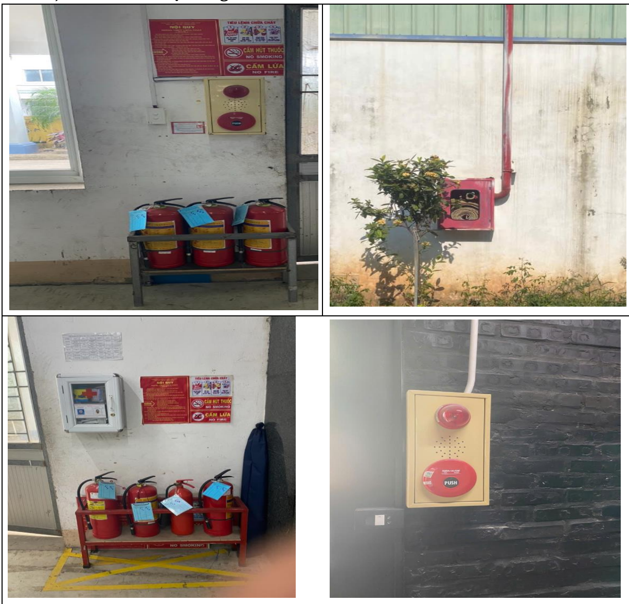
Hình 3.8. Hình ảnh về hệ thống PCCC của cơ sở
