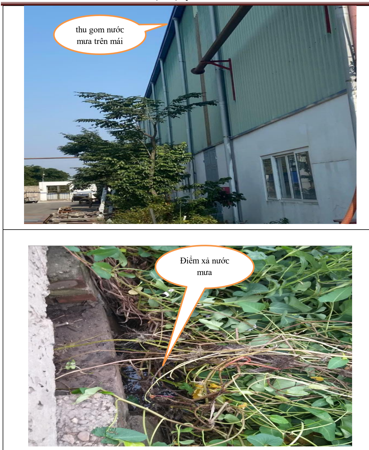
Hình 3.2. Hệ thống thu gom nước mưa bề mặt và trên mái ở cơ sở
