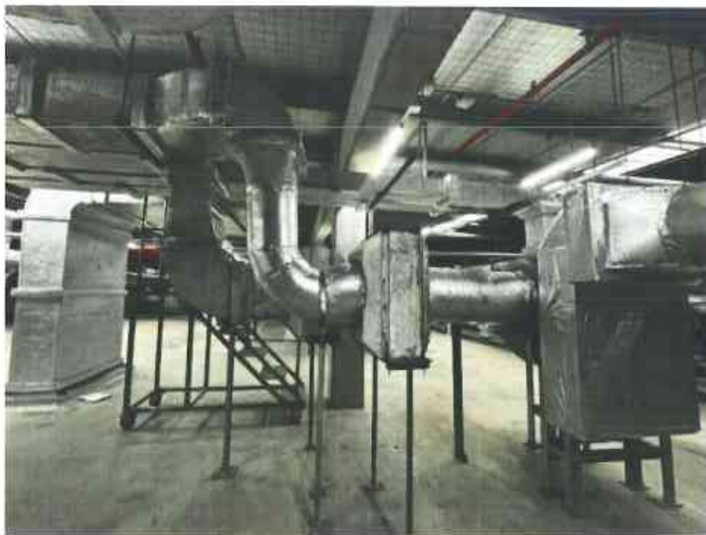
Hình 11. Hệ thống xử lý khí thải khu vực phòng thí nghiệm
