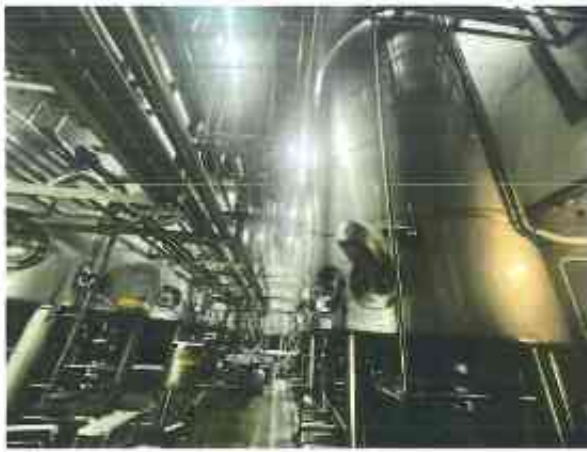
Khu vực phối trộn (bồn chuẩn hoá)
