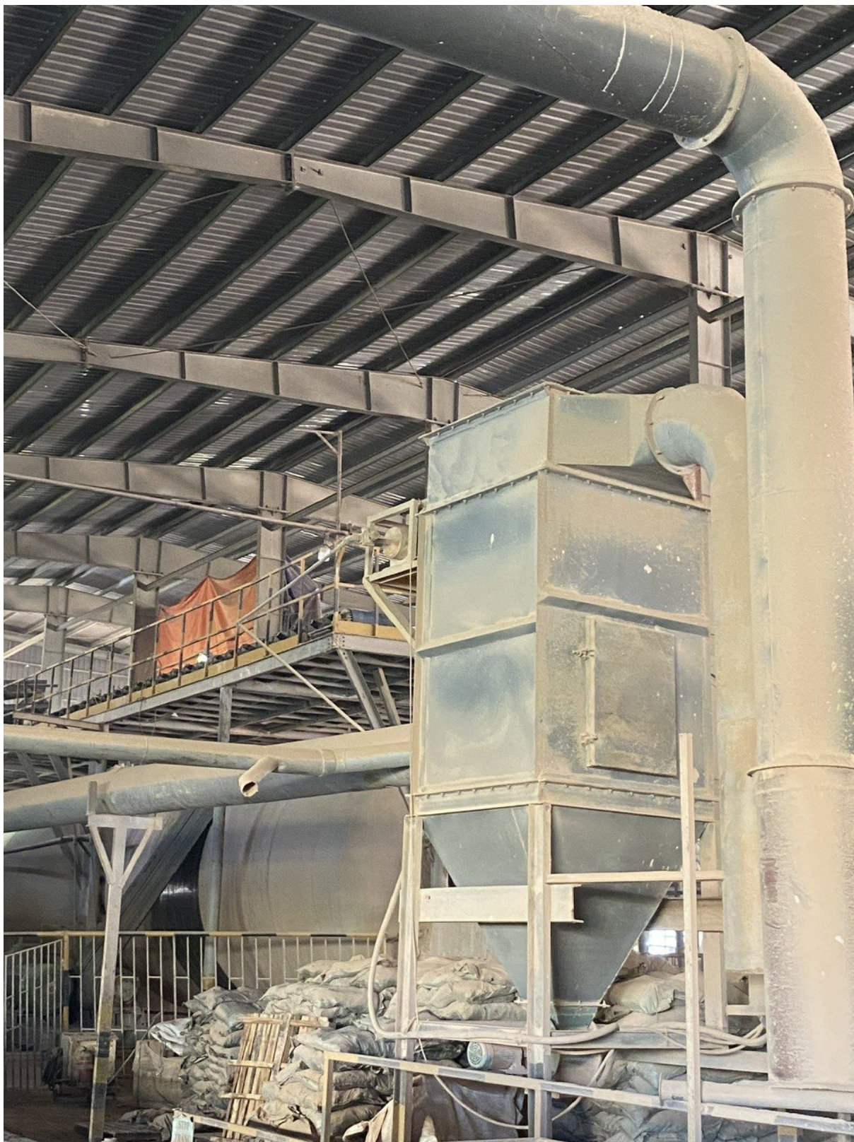
Hình 1. 4 Hệ thống xử lý bụi khu vực nạp liệu đầu vào hiện có của Nhà máy
