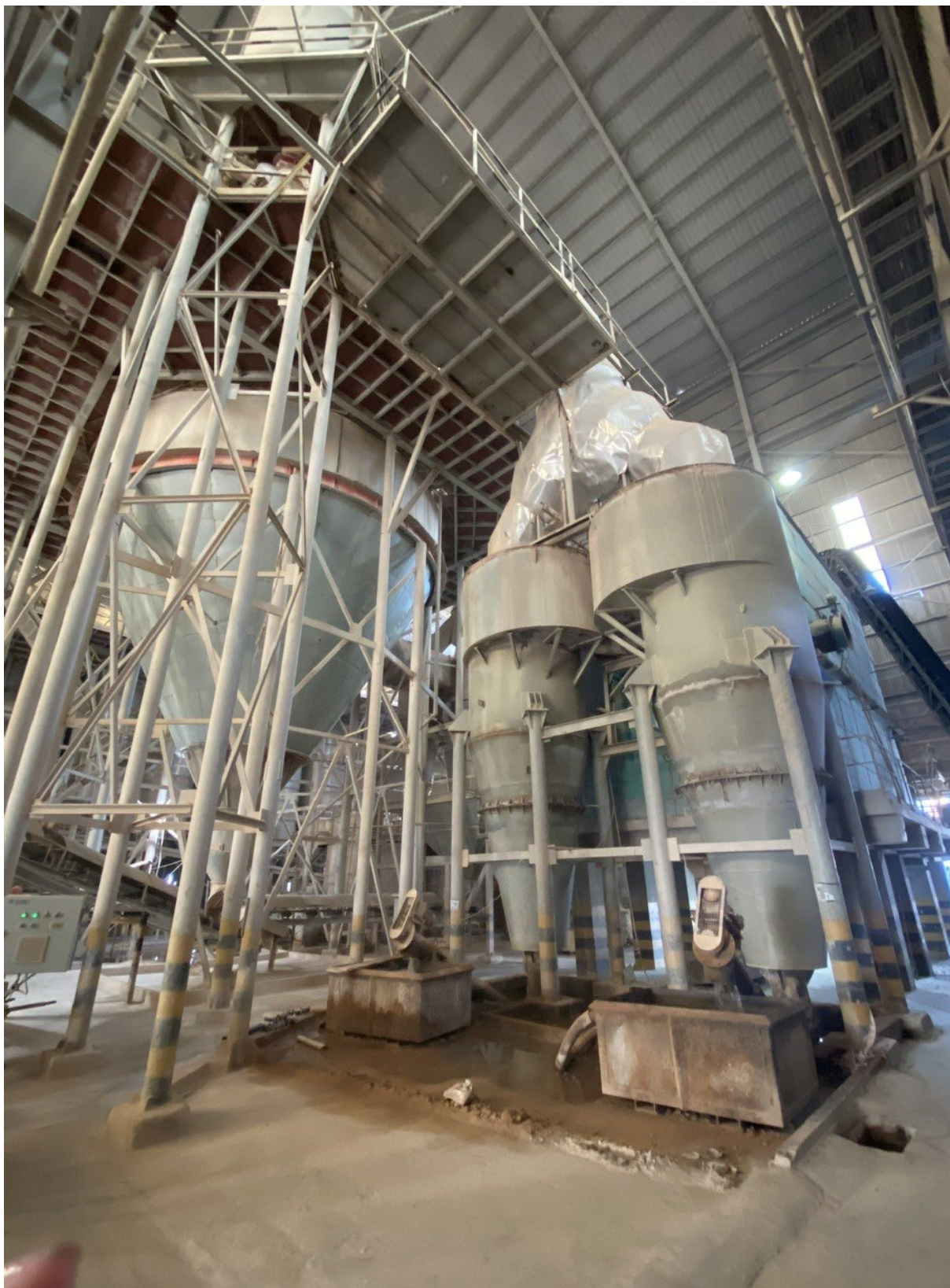
Hình 1. 6 Hệ thống xử lý bụi bằng tổ hợp Cyclon của lò sấy phun hiện có của Nhà máy
