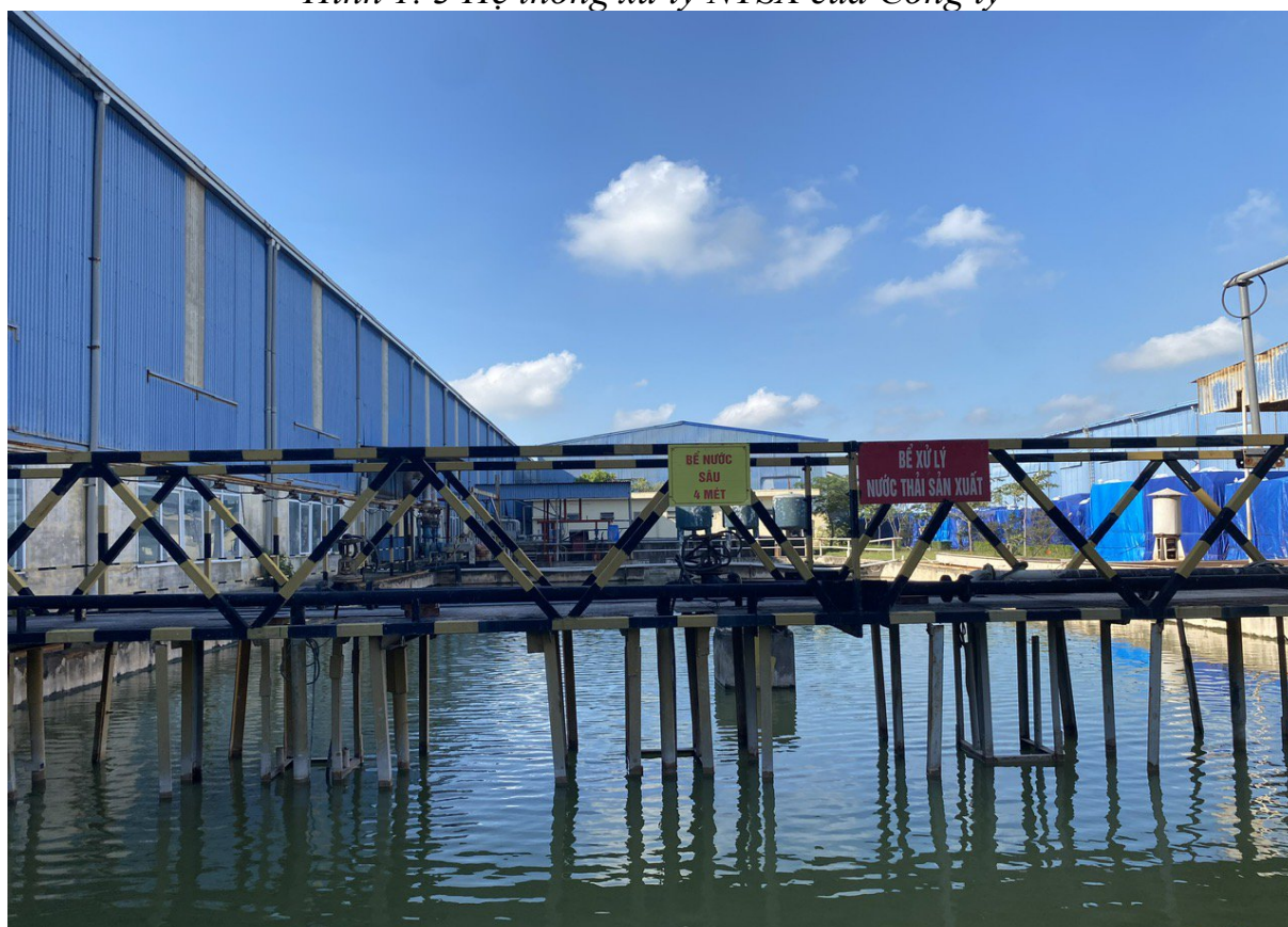
Hình 1. 3 Hệ thống xử lý NTSX của Công ty
