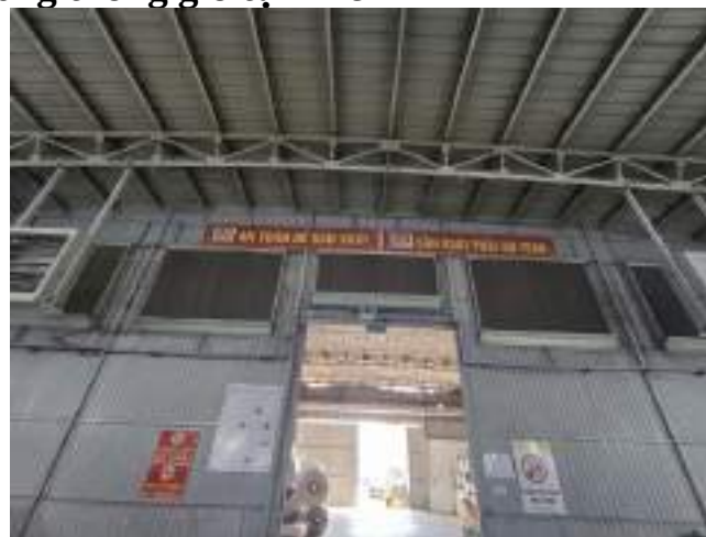
Hệ thống làm mát nhà xưởng bằng tấm Cooling Pad
