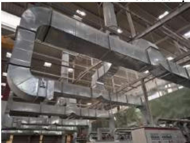
Hệ thống cấp gió tươi cưỡng bức cho nhà xưởng
