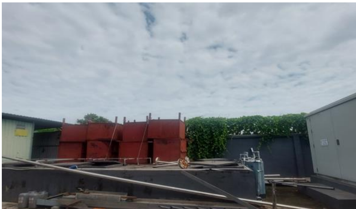
Hình 3. 6.Hình ảnh Trạm xử lý nước thải của Công ty
