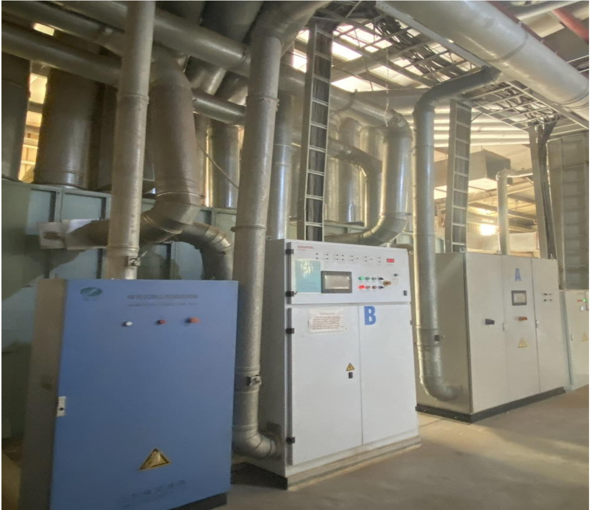
Hình 3. 5. Hệ thống lọc bụi tổ ong hiện có tại Nhà máy
