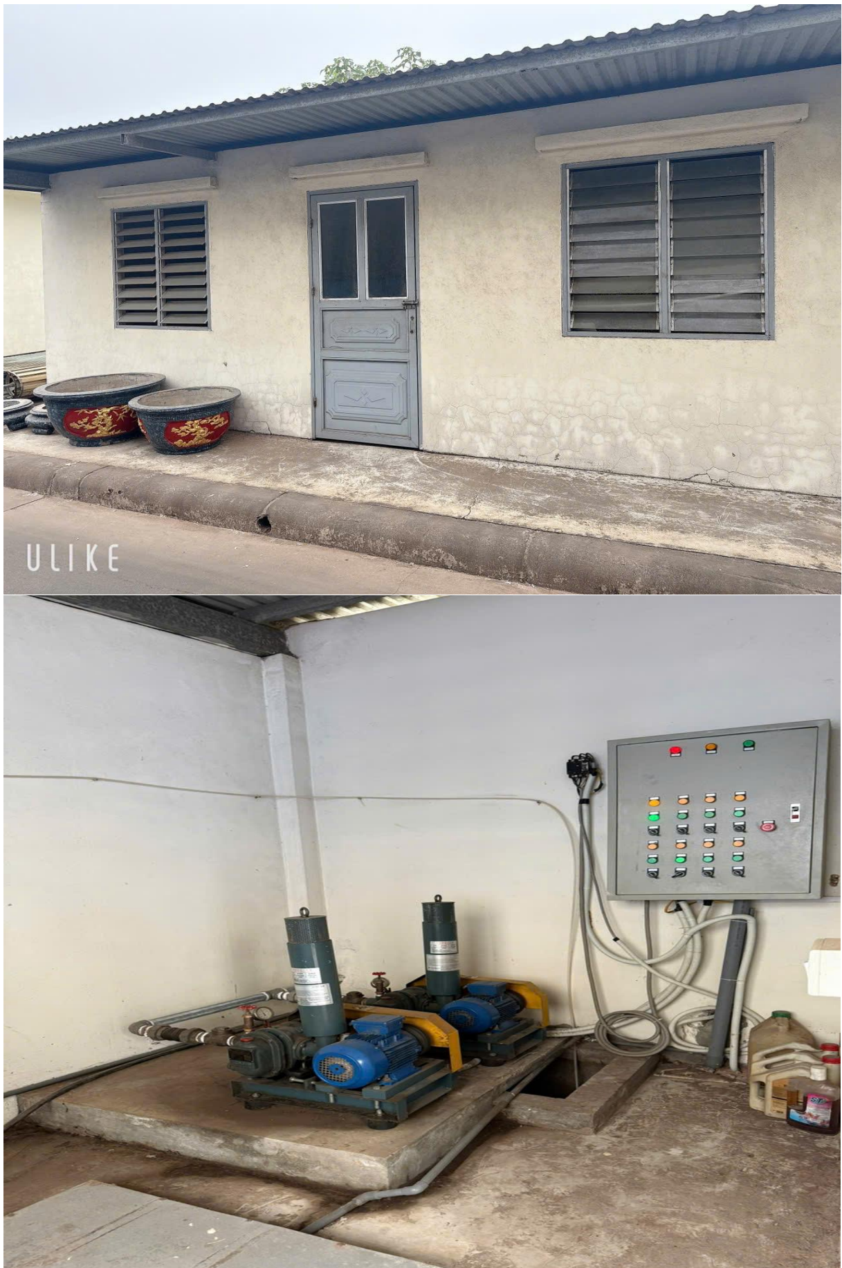
Hình 3. 1 Trạm xử lý NTSH hiện có của Nhà máy
