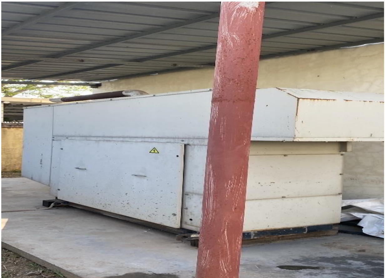
Hình 3. 8 Máy phát điện dự phòng hiện có của Nhà máy
