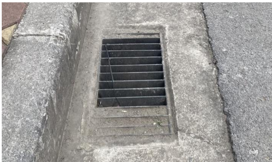
Hình 3.1. Các hố ga thoát nước mưa
