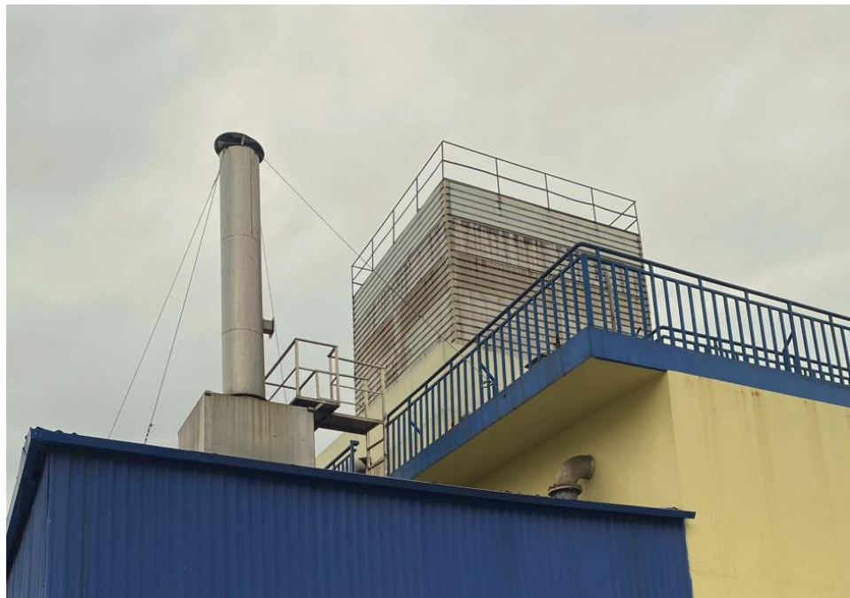
Hình 3.10. Hình ảnh hệ thống thu gom và xử lý khí thải phát sinh từ bể gom của hệ thống xử lý nước thải
