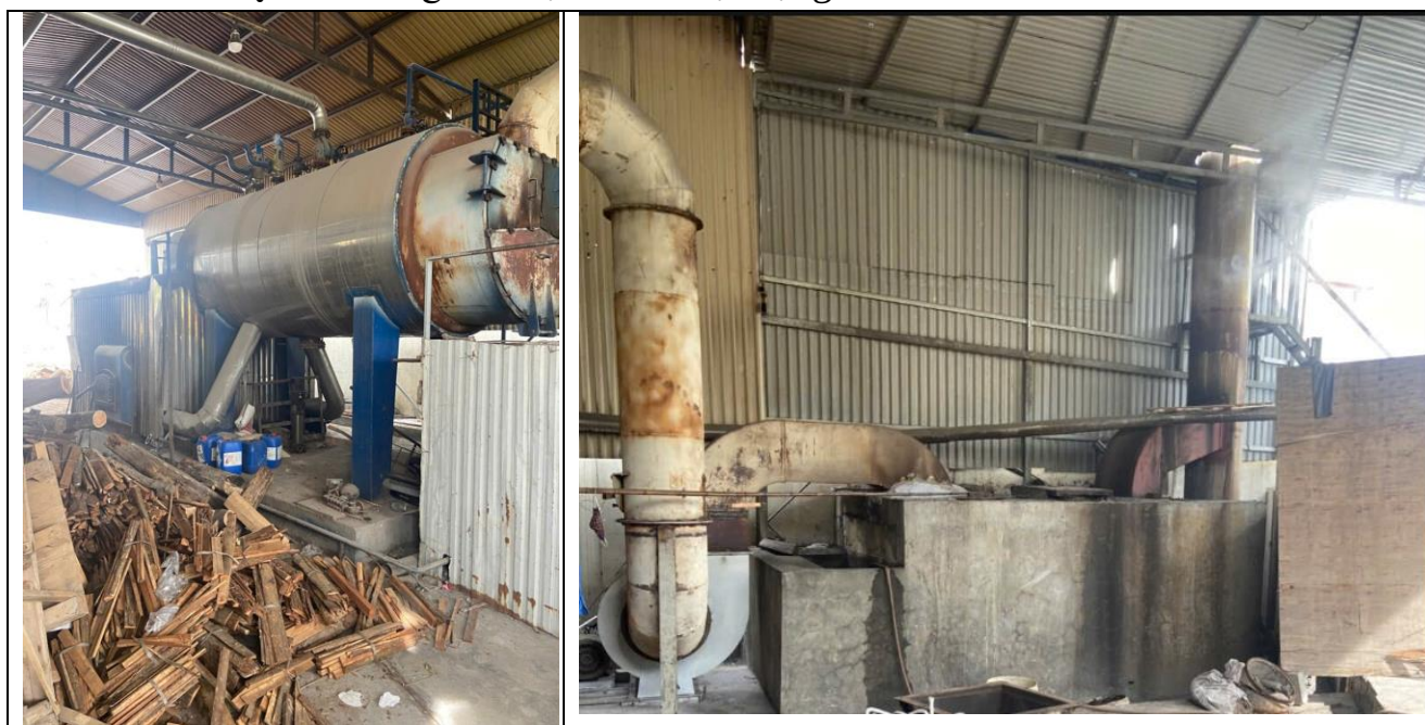
Hình ảnh khu vực lò hơi
