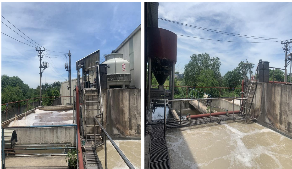
Hình 3.2. Hình ảnh công trình xử lý nước thải của cơ sở
