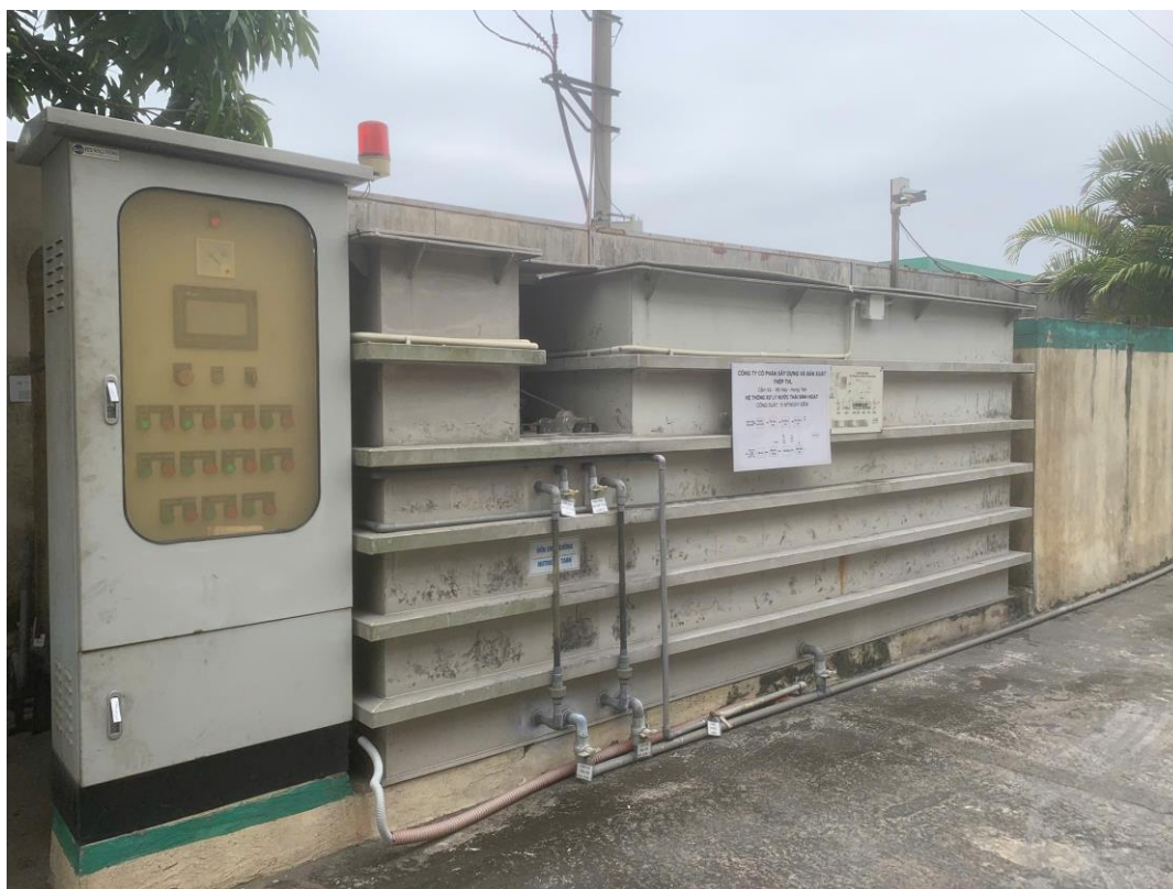
Hình 3.3. Hình ảnh hệ thống xử lý nước thải công suất 10 m 3 /ngày đêm - Công trình xử lý nước thải sinh hoạt đầu tư bổ sung
