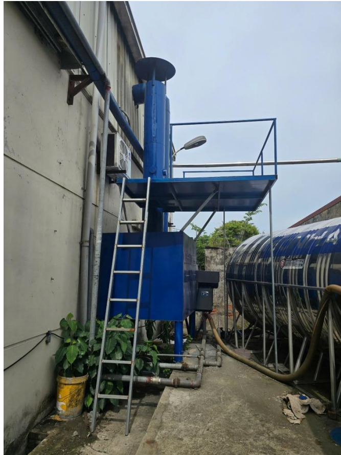
Hình 3.5: Hình ảnh hệ thống xử lý hơi hóa chất từ quá trình nhuộm và sấy chỉ
