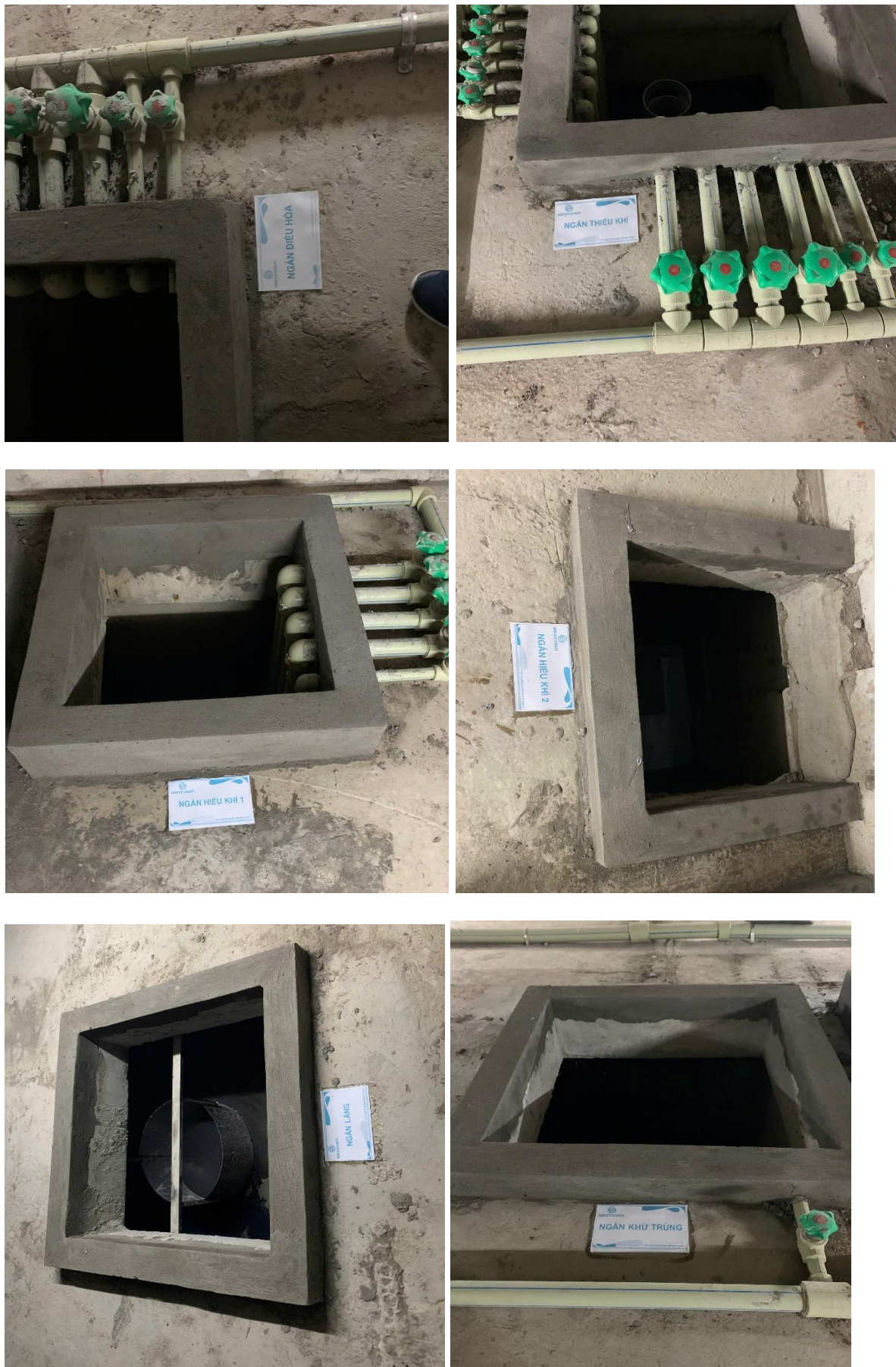
Hình 3. 2 Các bể xử lý nước thải của dự án
