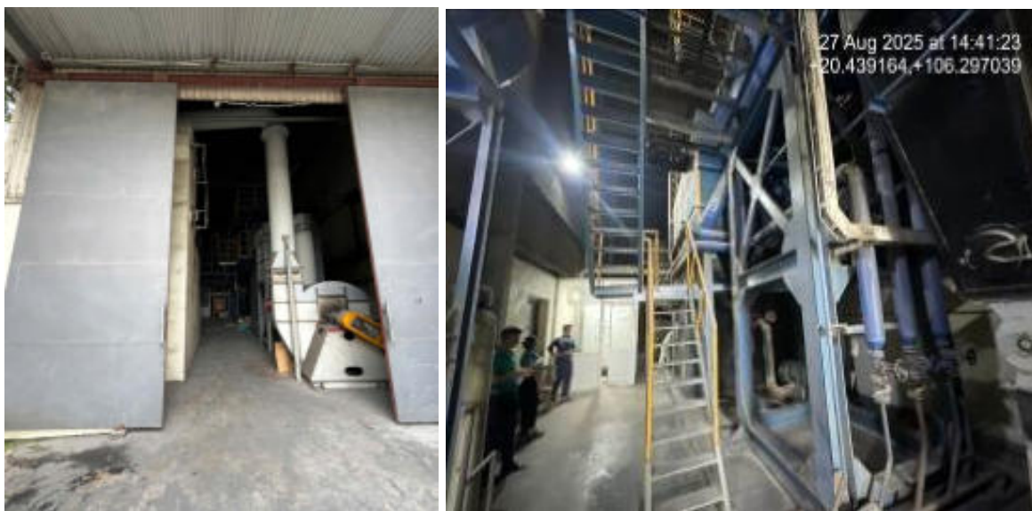
Hình 3. 13 Khu vực nhà lò hơi tầng sôi
