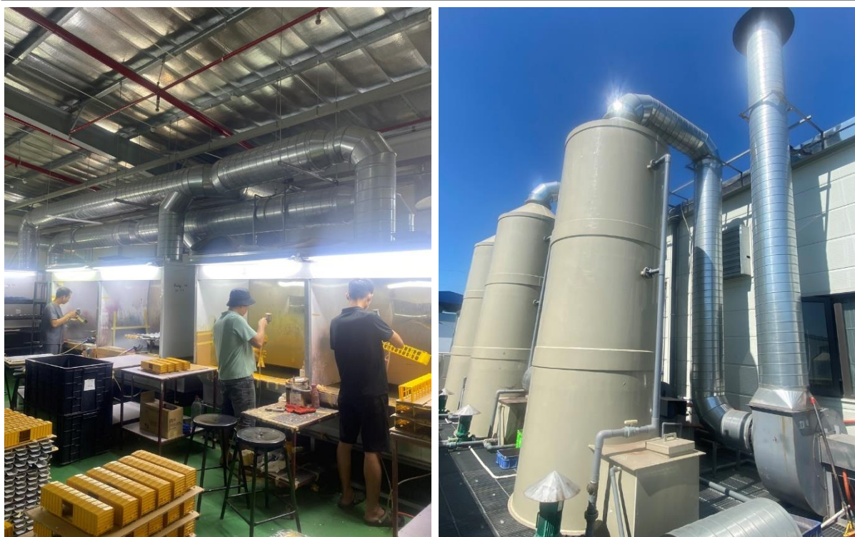
Hình : Hệ thống đường ống thu gom và tháp dập bụi của hệ thống xử lý khí thải đã đầu tư của dự án
